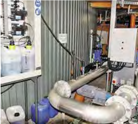
Enzyme und Spurenelemente werden automatisch zudosiert.
